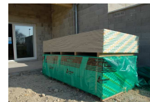
Des plaques de plâtre ayant une épaisseur de 13 mm sont stockées et vont servir à la réalisation des cloisons.
