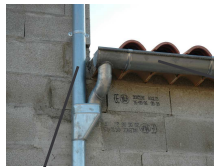
Descente d'eau qui permet d'évacuer l'eau de pluie des gouttières.
