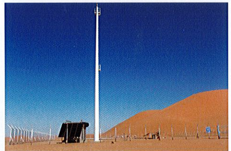
Antenne de transmission d'information
